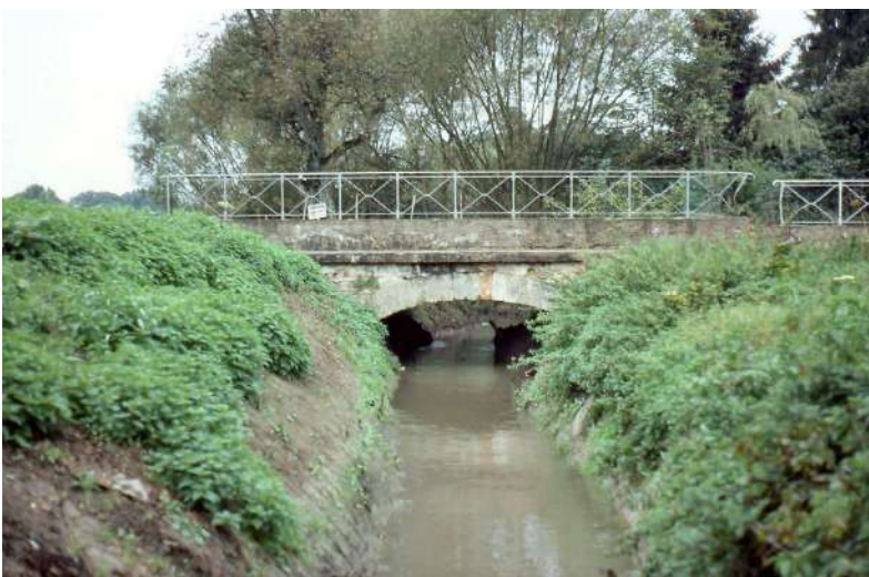
D402 - Pont de Guignes sur le rû d'Avon – Seine et Marne
