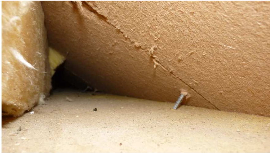
Pont thermique de mise en œuvre : non respect de la prescription pour la pose de l'isolation de charpente. Pose manuelle des lès d'isolant au lieu d'une insufflation d'isolant.
