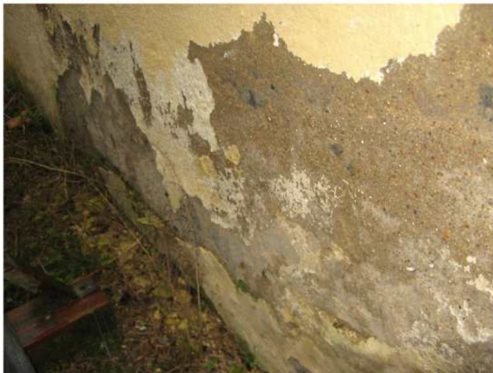
Dégradations d'enduits et pourrissement d'un mur par eaux de pluie s'infiltrant dans terrain voisin : le droit d'échelle n'existe pas pour travaux enterrés
